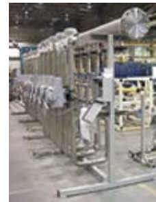
El balance de aire y gas en las tuberías es crítico
